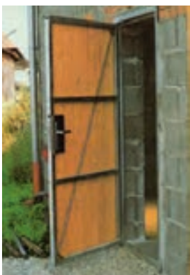
Tür ohne Isolierung innen
